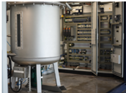
Integration aller Anlagenkomponenten in einen 20-Fuß-Seecontainer
