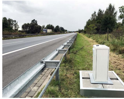
Fahrzeugdetektion an zweispuriger Autobahn
