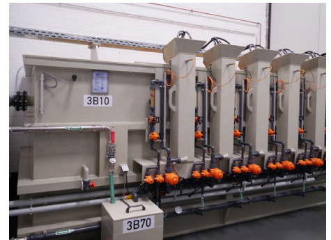
Elektrolysestufe des INAR-Industrieabwasser-Behandlungssystems
