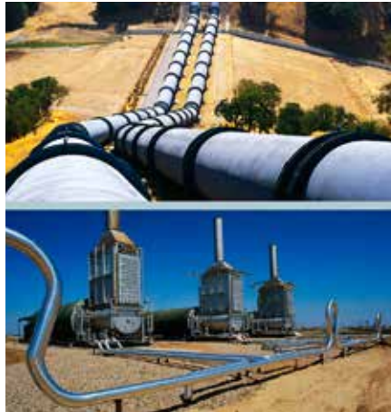
Energierückgewinnung im Erdgasnetz
