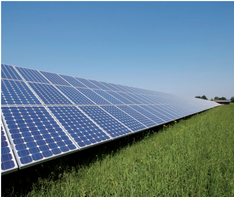
Freiland Solarpark Sanzenbach (2MW p Gesamtleistung)
